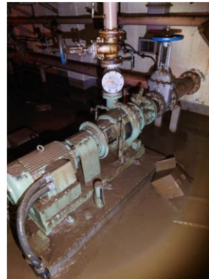
冠水した設備
