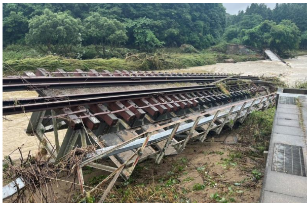
第6厚狭川橋梁の崩落 (衛生センター裏/大嶺町西分)
