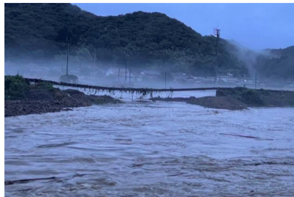
線路の盛土流出 (四郎ヶ原下/大嶺町西分)
