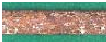
図 鉄筋の腐食
