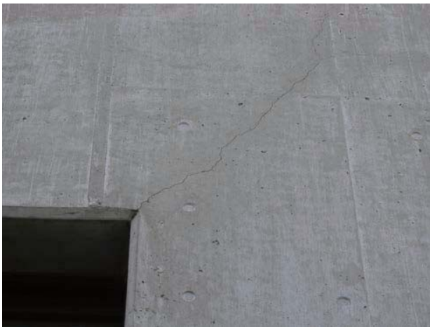
図 コンクリートのひび割れ
