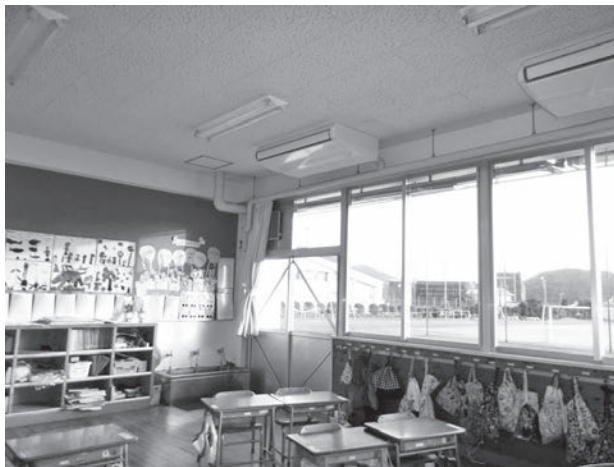
大田小学校の教室に設置された空調設備
