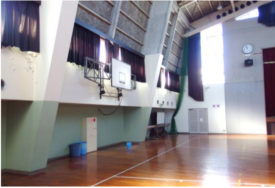
体育館平土間部分。雨漏りが原因となり、壁面(写真カーテン下部分)の塗装が部分的に剥離している。
