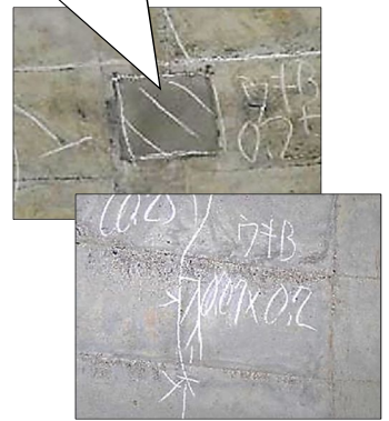
写真 4-2 II a の損傷
