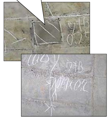
写真 4-2 II a の損傷
