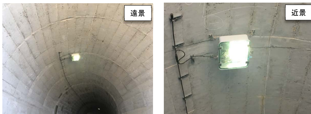
写真 2-1 照明施設(秋吉台隧道)
