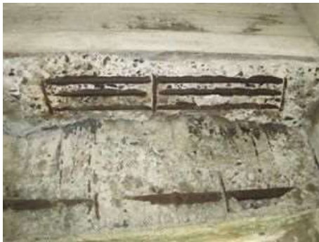
写真2-2 上部工Con(主桁・横桁)の損傷状況
