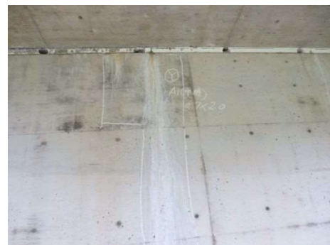
写真2-5 下部工(橋台・橋脚)の損傷状況
