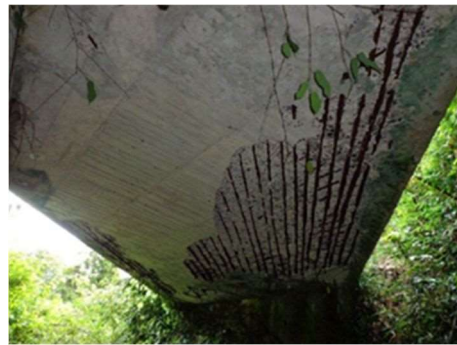
写真2-3 上部工Con(床版・間詰)の損傷状況
