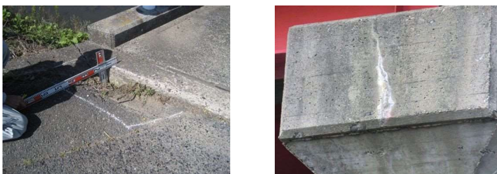
写真2-7 上部工その他(舗装)、下部工(橋台・橋脚)の損傷状況
