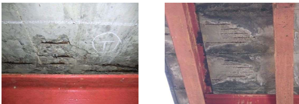
写真2-6 上部鋼(Con床版)の損傷状況
