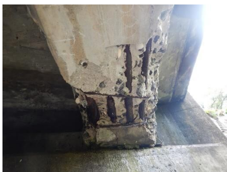
写真2-2 上部工Con(主桁・横桁)の損傷状況
