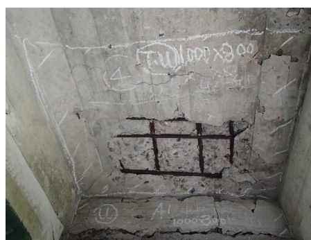
写真2-3 上部工Con(床版・間詰)の損傷状況
