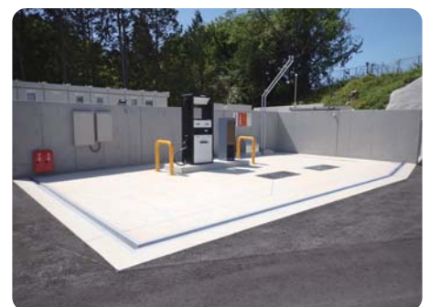
災害時用自家用給油施設
